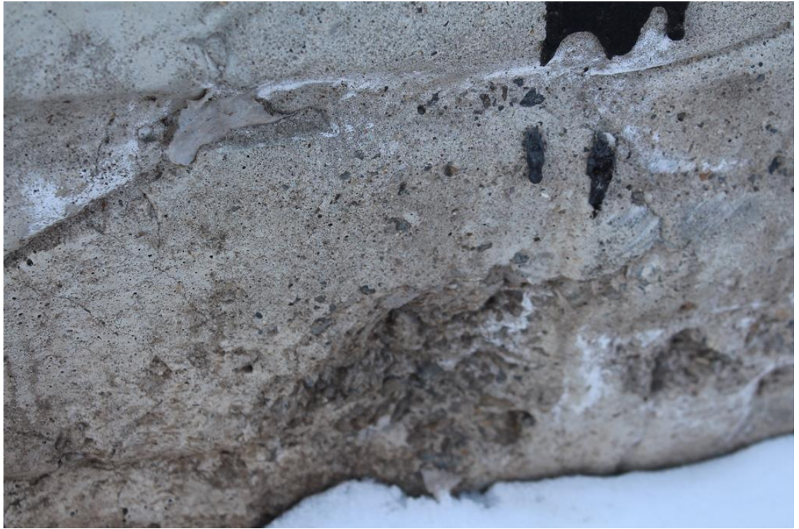
Фото 7. Сколы на поверхности бетона
