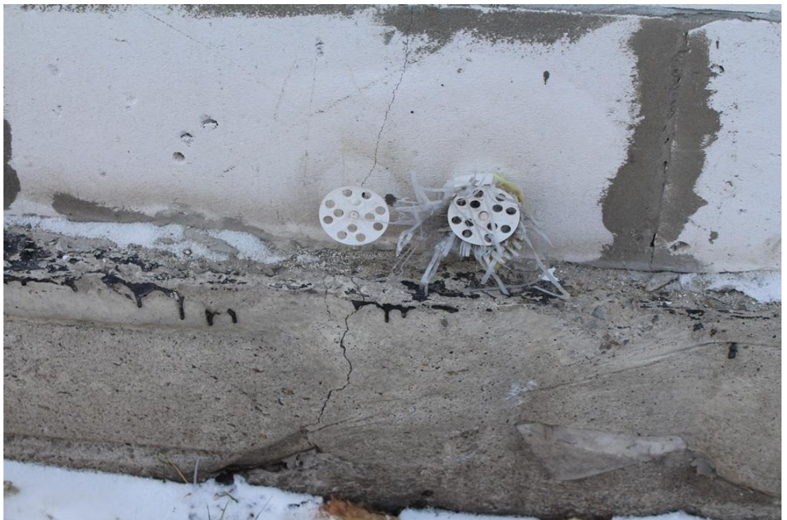
Фото 8. Трещина в кладке наружных стен и фундамента
