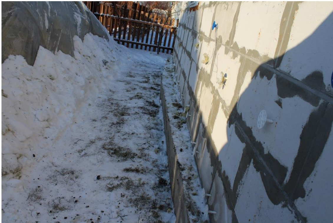
Фото 9. Нарушение геометрии ленточного фундамента
