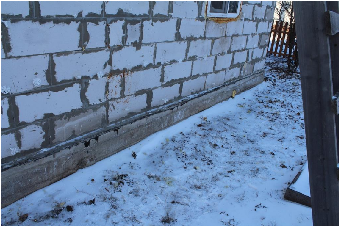
Фото 6. Высолы на поверхности фундамента
