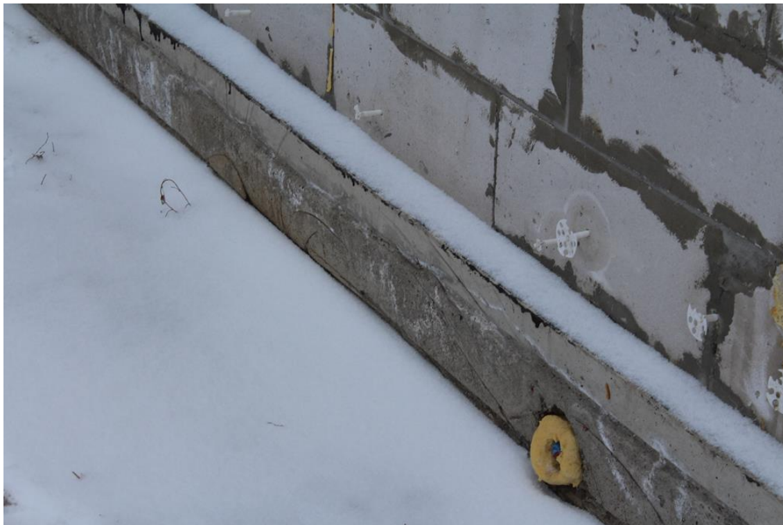
Фото 13. Выветривание бетона из поверхности фундамента
